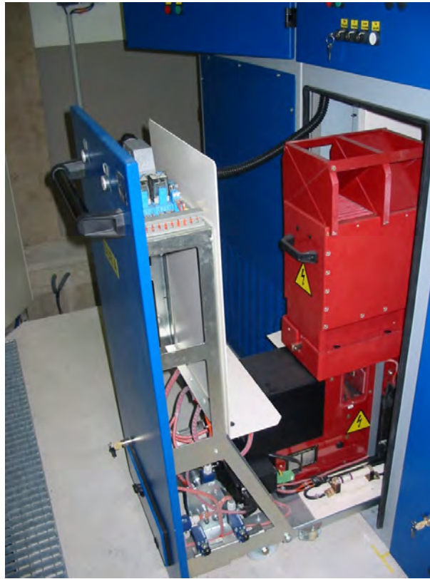
Figure 1 : Photo d'un chariot disjoncteur traction débroché – Tramway de Montpellier
